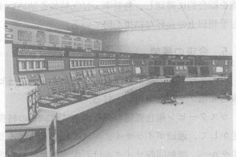
図-7 東新潟第3号系列の中央制御盤
