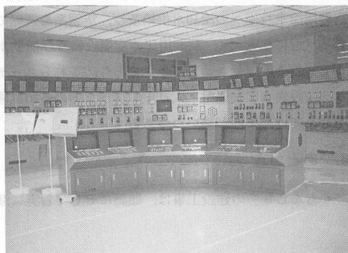
写8 中央制御室
