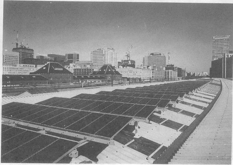
写真1 東京駅ホーム上屋に設置した太陽光発電
