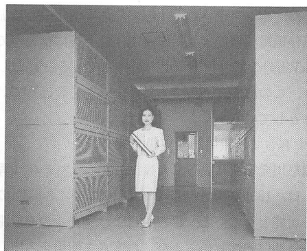
写真1 変電所設置用500kW級システム
