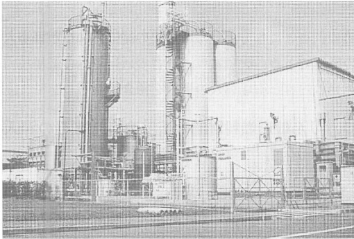
写真1 バイオガス燃料電池発電システム設置状況 (サッポロビール株式会社 千葉工場)
